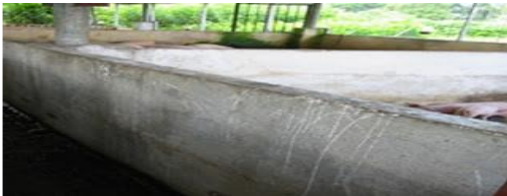
Instalación porqueriza integrada
