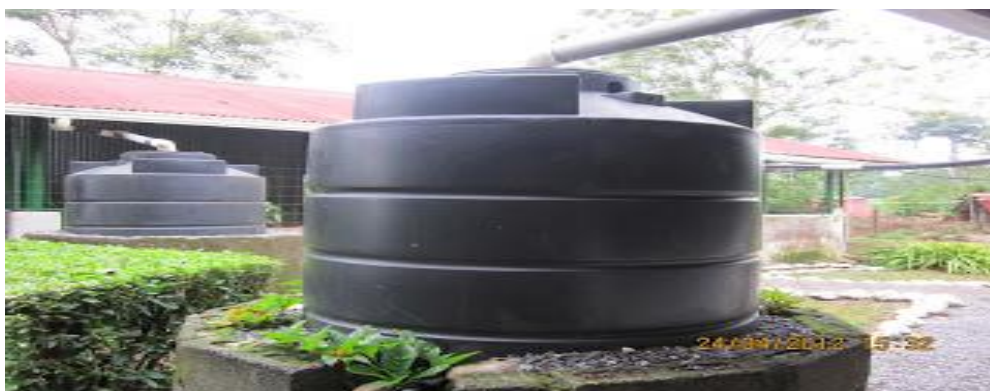
Tanques almacenamiento de aguas lluvias
